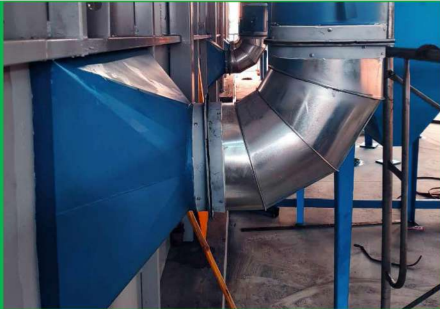
CÔNG TRÌNH: HỆ THỐNG TẠI NHÀ MÁY AKI
